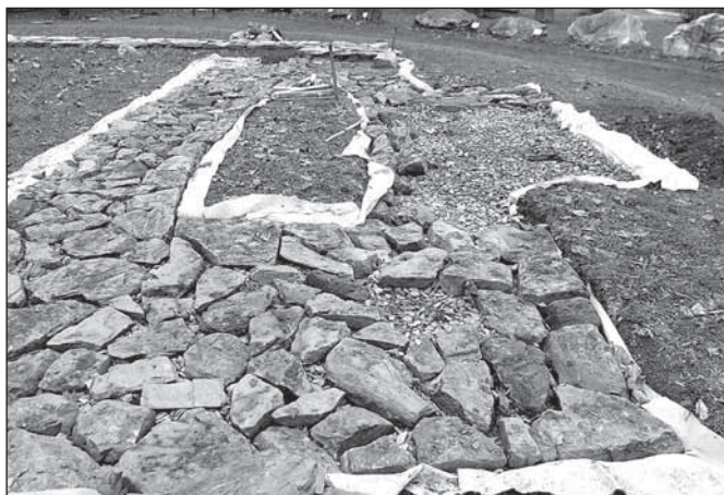
...a přistavěného otopného zařízení (vpravo), stav k 12. 11. 2019
