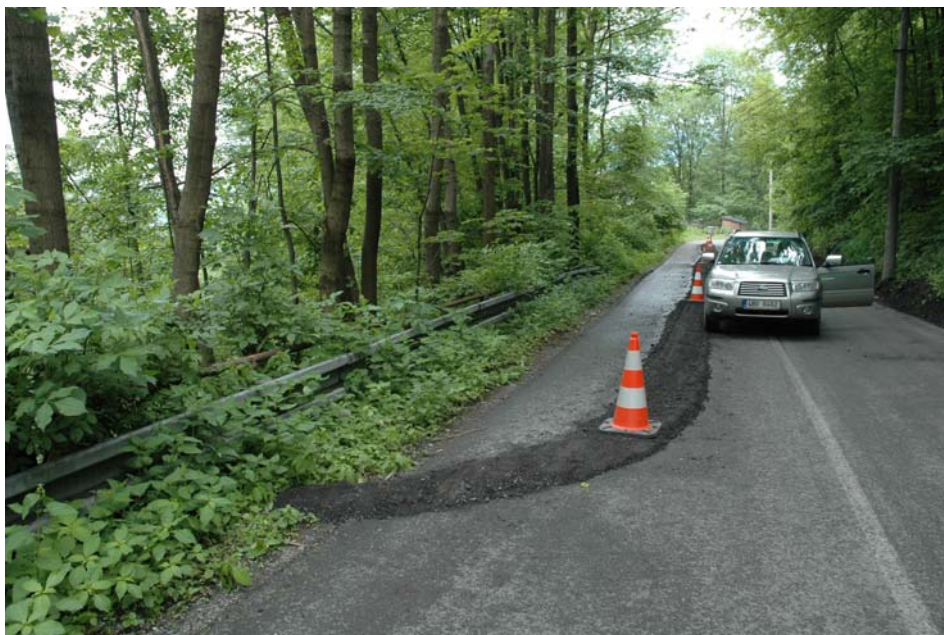
Provizorně zakryté trhliny odlučné hrany v silnici v sesuvném území Skalice. O. Krejčí, červen 2010.
