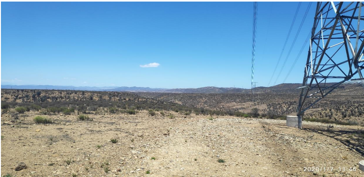
Imagen 3.- Fotografía que da cuenta de la línea de transmisión eléctrica
