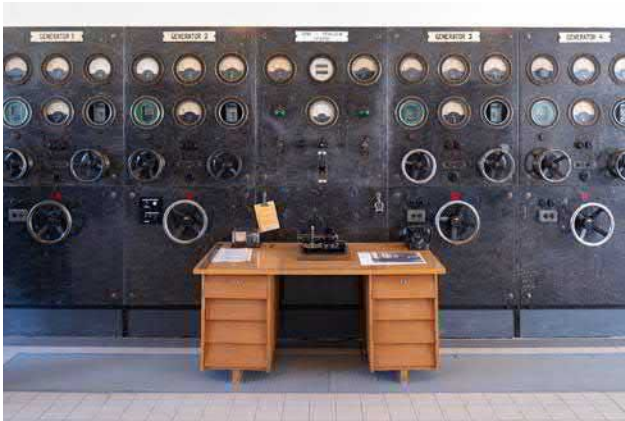
Obr. 4-3 Poděbrady, vodní elektrárna. V rámci modernizace došlo k výměně převodů, generátorů a řídicích mechanismů. Původní řídicí pracoviště zůstalo po ukončení provozu zachováno na místě (foto Viktor Mácha, 2019).
