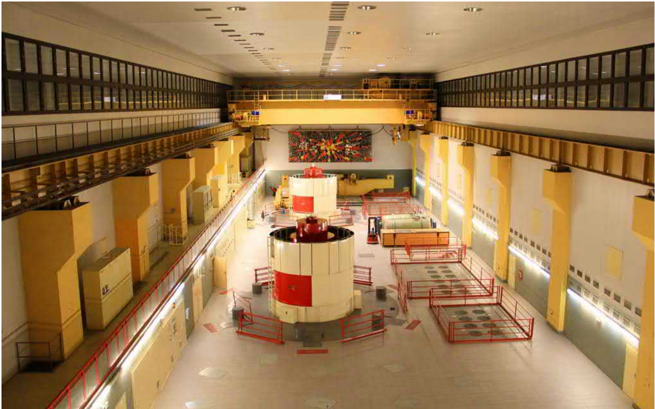
Obr. 9-25 Pohled na současnou strojovnu elektrárny (foto Jan Höll, 2021).
