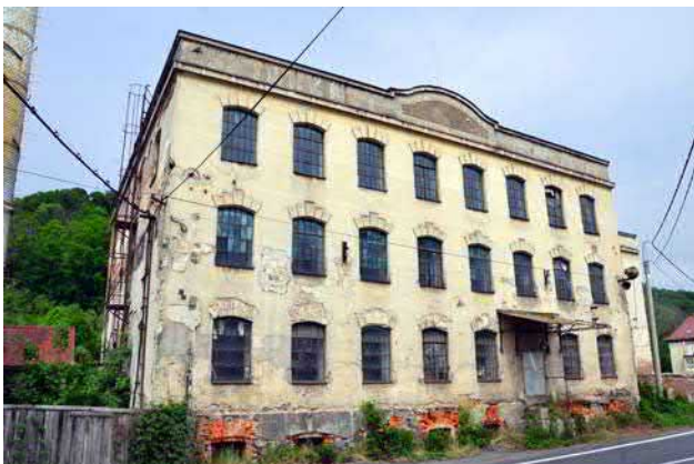
Obr. 10-36 Františkov nad Ploučnicí, přádelna č. p. 125, pohled na hlavní průčelí přádelny (foto Miroslav Kolka, 2022).
