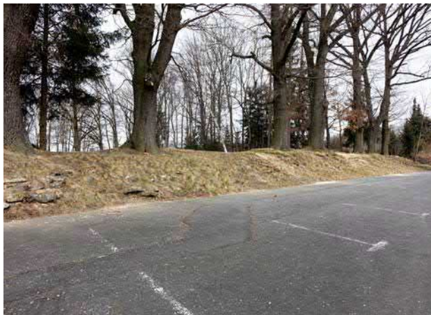
Obr. 11-39 Bývalá boční („malá“) hráz Zbýšovského rybníka v současném kempu. Pohled na návodní stranu se zbytky tarasu (foto Jindřich Frajer st., 2022).
