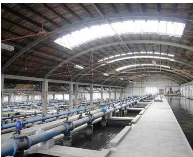
Obr. 4-2 Plzeň, Puech-Chabalova filtrace městské vodárny Na Homolce. Nedostatečná kvalita vody dodávaná městskou vodárnou vybudovanou na konci 19. století vedla ve 20. letech 20. století k rozšíření technologie čištění o filtrační systém Puech-Chabal. Na území dnešní ČR byly instalovány pouze tři tyto systémy a plzeňský příklad je jediným dochovaným, navíc dochovaným v autentické podobě. Současné využití pro rybí sádky využívá typologických daností stavby bez zásahů do stavební podstaty nebo technického zařízení (foto Michaela Ryšková, 2020).
