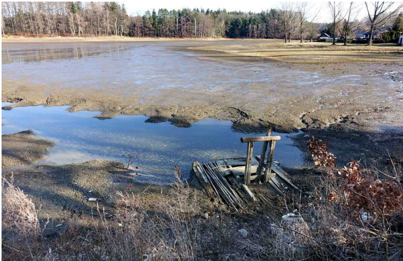
Obr. 11-36 Ovládání hlavní spodní výpustě Zbýšovského rybníka (foto Jindřich Frajer st., 2022).
