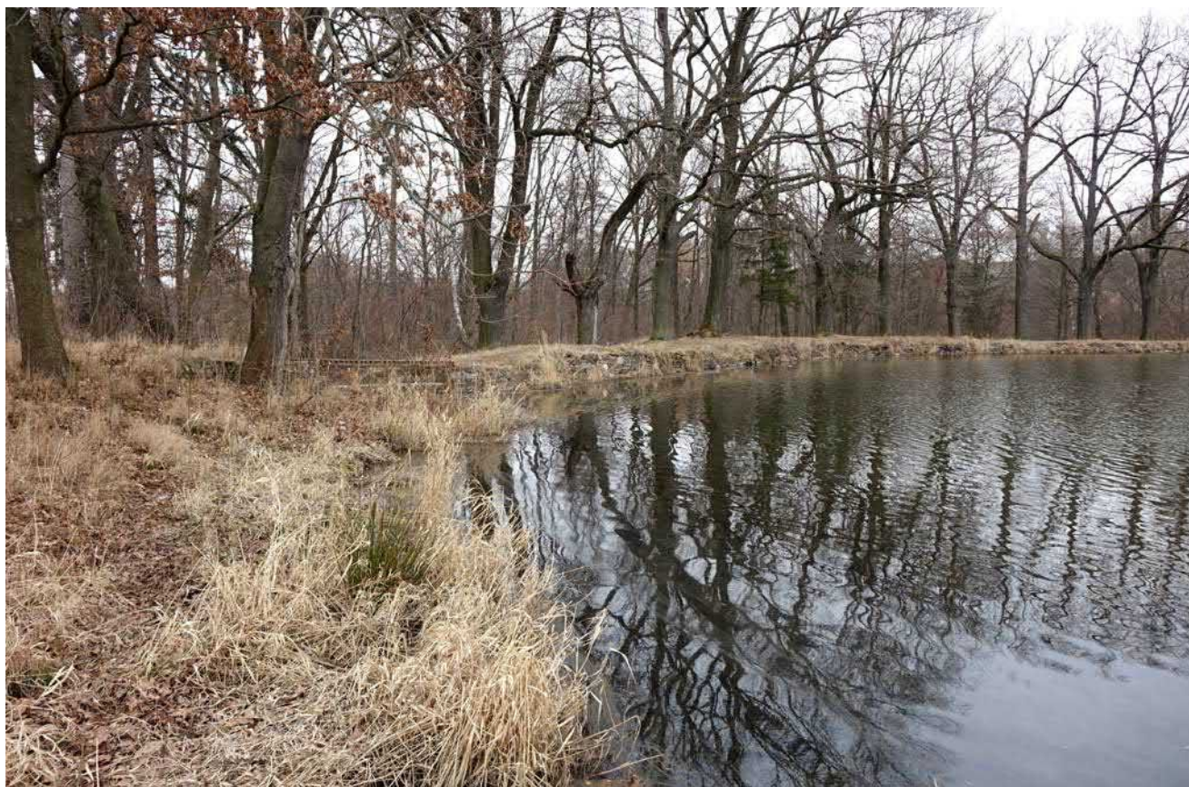
Obr. 11-42 Hráz Pilského rybníka (foto Jindřich Frajer st., 2022).
