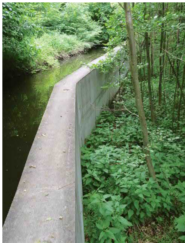
Obr. 8-31 V exponované části náhonu bylo kamenné zdivo nahrazeno betonem (foto Radka Račoch, 2021).
