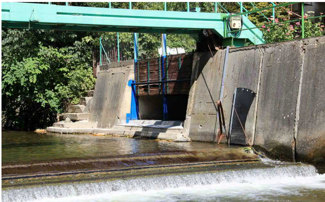
Obr. 9-10 Lokalita MVE Víkýřovice Mazánek – vtoková část se stavidlem a jezem na řece Desná (foto Renata Pavelková, 2021).
