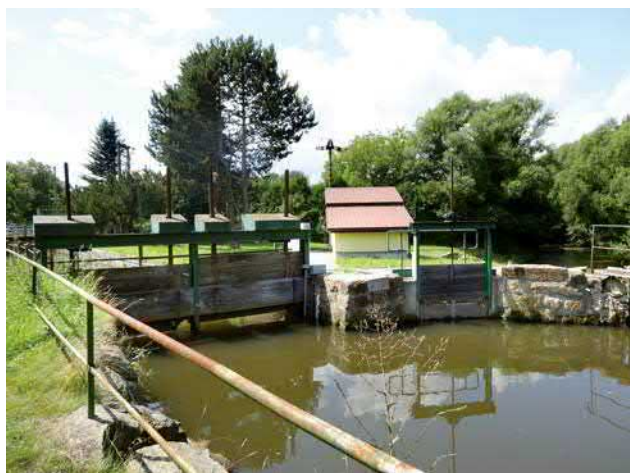
Obr. 9-3 Ukázka řešení MVE Sudkov – jez, kdy žlutý objekt je turbínovna a před ní malá stavidla do zatrubněného krátkého náhonu k ní. Velká stavidla jsou náhon pro historickou MVE Sudkov (foto Renata Pavelková, 2021).
