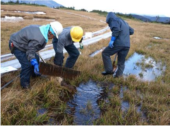
① 排水不良になっている箇所は、下側の土留板を撤去するなどして、排水路をできるだけ確保する (St. 09-01) * 植被が見られる部分は、実験区脇の裸地に表土の泥炭ごと移植する
