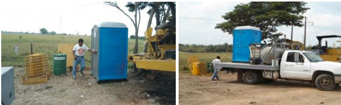
Figura 2. Instalación de baños portátiles en los frentes de trabajo Ejemplo tomado de los manuales de la SCT
