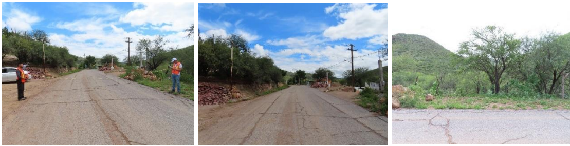
Figura 1. A) Inicio del camino de terracería (Km. 2+000)
