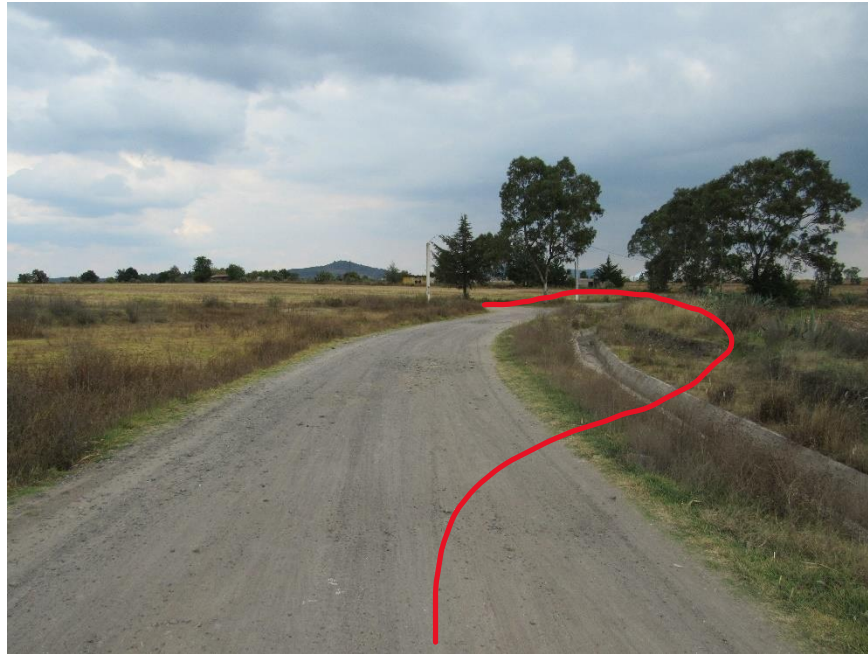
Figura 22. En este punto es aproximadamente el Km 2+650.00, del lado derecho de la imagen la curva requiere ajustarse ocupando hasta los magueyes que se observan, por lo que estos serán removidos
