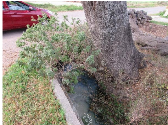
Lado derecho del sitio de la obra de drenaje, dominan los pastos, se prevé que este árbol de fresno sea afectado
