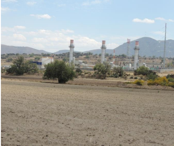
Vista de la Central EVM I
