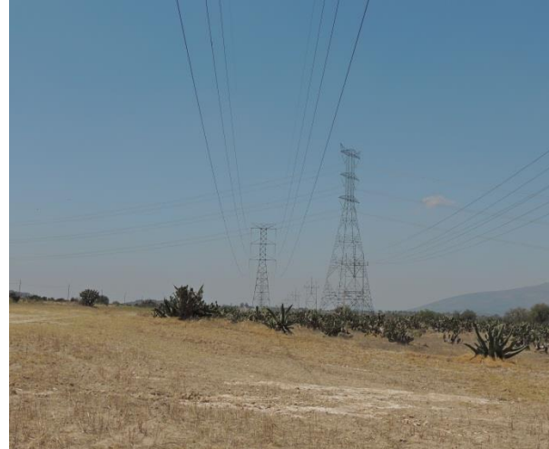
Líneas de transmisión eléctrica existentes en el SAR
