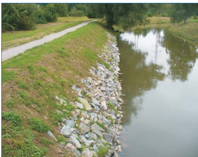
K. ú. Maloměřice - sanovaná pata hráze
