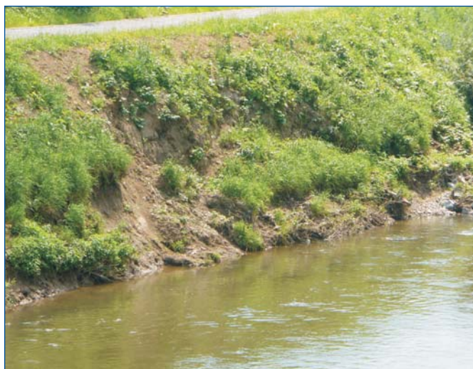
K. ú. Holásky - sesuv břehu v místě probíhající stavby cyklostezky
