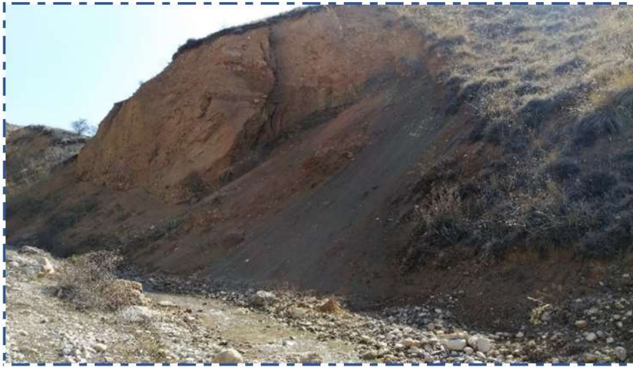
Şəkil 1. Havuşçay dərəsində sürüşmə.
